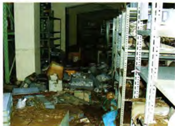
写真3・4 調査員室・収蔵庫の被災状況
