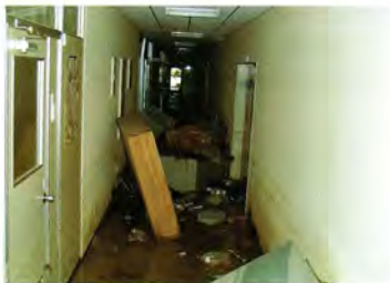
写真2 埋文センター内の被災状況
