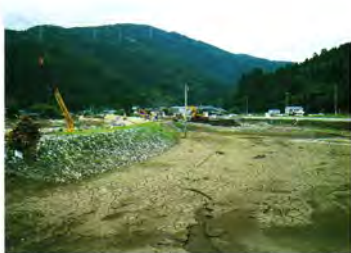
埋蔵文化財調査センターから見た足羽川の堤防決壊現場
